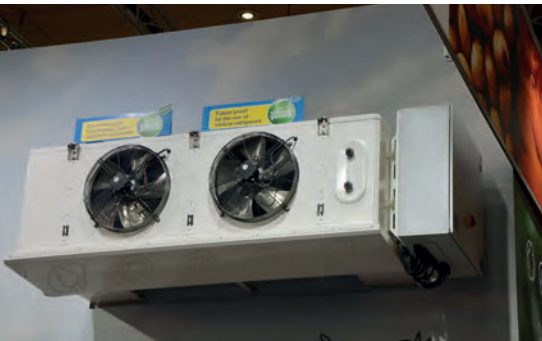
Moderne Kühlanlagen arbeiten energieeffizienter und nutzen umweltschonende Kältemittel.
